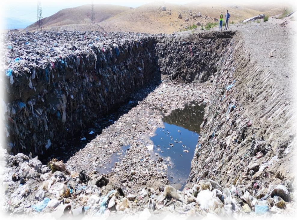
Şekil 3.5. Geçici sızıntı suyu toplama havuzu.
